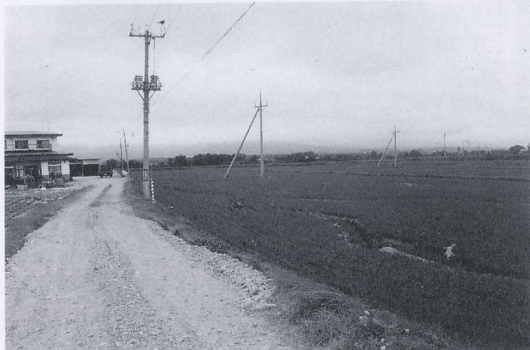
写真 4.4.30 今金町豊田の農道の被害(9) 右岸側田圃に入った川筋直交方向の亀裂 Cracks on the rice-field near the channel (9)
