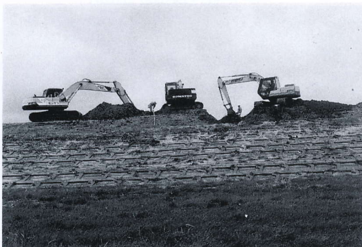
写真 4.4.35 後志利別川右岸堤防の被害（緊急の復旧工事） Urgent repairing works at the right bank of the river (2)
