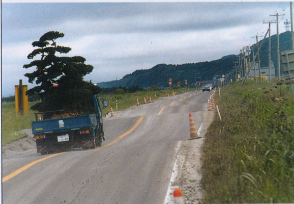
写真 4.10.8 25~30 m の波長で路面が上下に波を打っている道路（豊津～豊野間）
