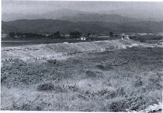
写真 4.8.3 厚沢部川河口、柳崎橋上流右岸堤防の被害 堤頂の縦横亀裂が発生している Damage to the bank of the Assabe river (right-hand side and upstream of the Yanagizaki bridge)
