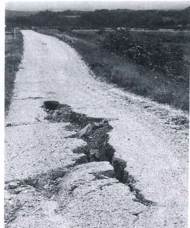
写真 4.4.16 パンケオイチャヌンペ川の堤防の被害 (1) 右岸堤防の沈下・亀裂 Longitudinal crack on the right bank (Panke-oicha-nunpe river)
