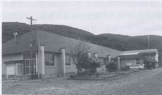
写真 4.4.7 丘の上の新成小学校 机、ロッカー、冷蔵庫などが移動したが、校舎には殆ど被害がなかった Shinsei elementary school built on the rock hill was damaged little
