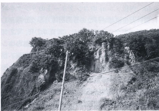
写真 4.2.9 斜面肩部の崩壊 Collapse of slope shoulder
