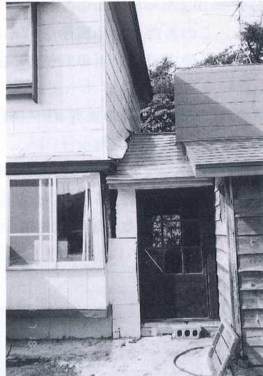
写真 4.2.14 地震により大きな被害を受けた民家(3) 戦後間もなく建造された向かって左側部分と大正12年頃建築された右側の旧建屋は分離した Severely damaged house on the re-claimed ground (3)
