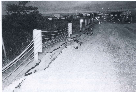
写真 4.10.15 函館本線を越える国道230号線の跨線橋の取付（盛土）は著しく沈下，破壊した。緊急修理してある Severely damaged approach road to overbridge Urgent repair works has been completed (National road No. 230)
