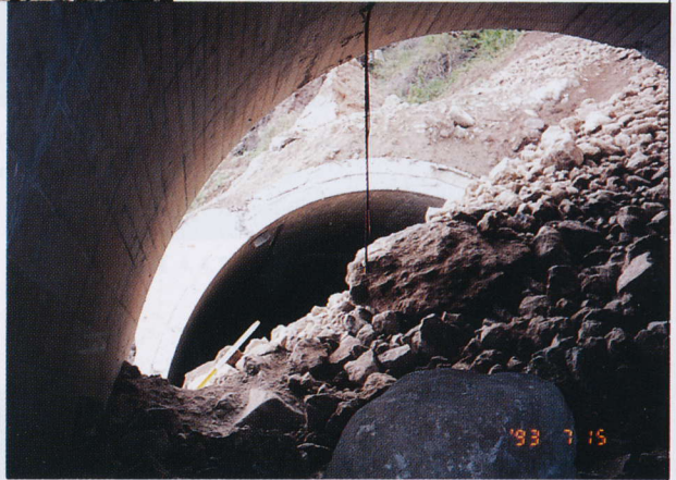
写真 4.2.16 第2白糸トンネルの被害(2) Damage to the second Shiraito tunnel (2)
