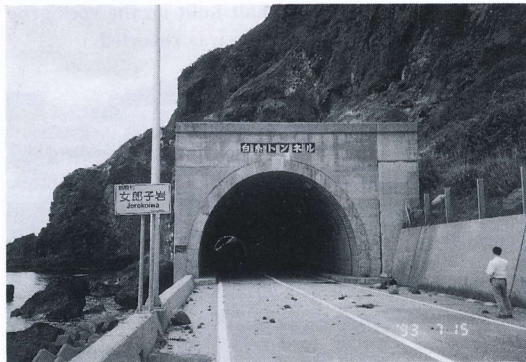
写真 4.2.15 第2白糸トンネルの被害(1) Damage to the second Shiraito tunnel (1)
