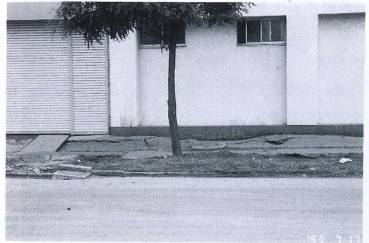
写真 4.9.12 北埠頭における上屋と地盤の沈下 Warehouse and uneven settlement of the ground, Kita-Futo
