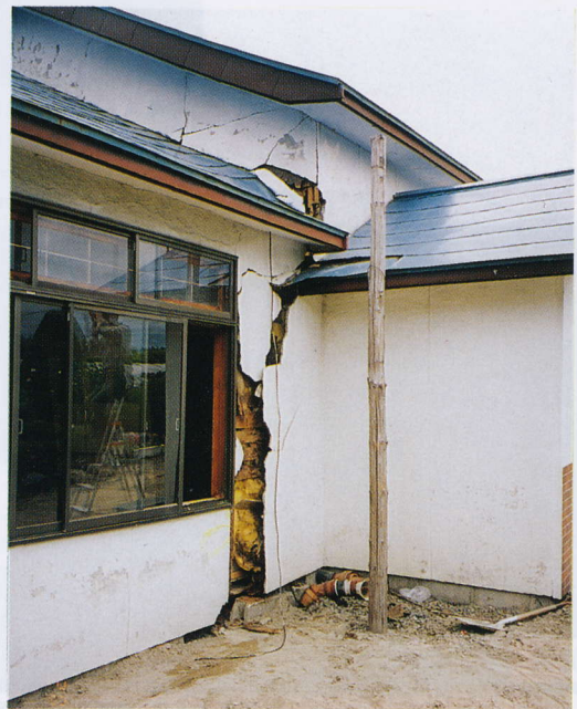
写真 4.4.40 著しい被害を受けた山崎氏邸(今金町八 束地区)(2) 家屋で正面より左側部分が左側に移動 し、家は引きさく様に変形した Damage to a house on a lanol re- claimed from an old river bed (Ima- gane town) (2)
