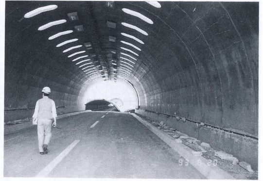
写真 4.1.12 千畳坂覆道の被害 (1) Damage to Senjo-zaka shed (1)
