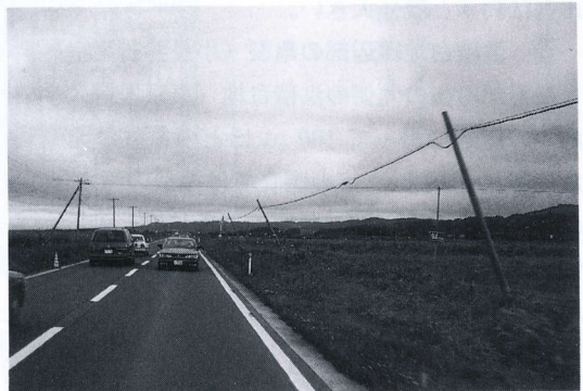
写真 4.10.9 電柱の傾斜 (豊野) Tilted electric poles (Toyono)
