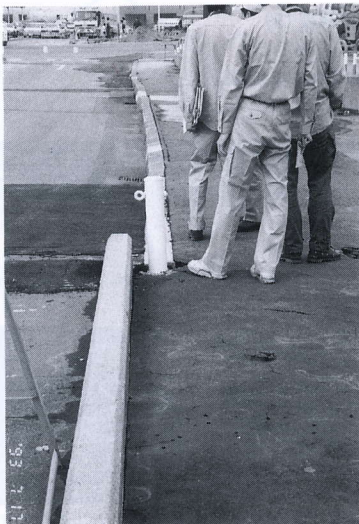
写真 4.9.19 東日本フェリーターミナルの被害(7) 地盤の変形によるとみられる柵のずれ Deformation of reclaimed land (H.N.F.T) (7)
