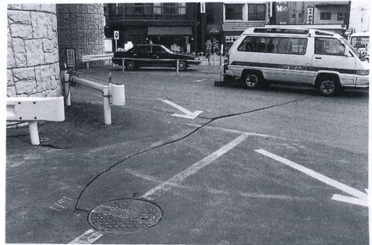
写真 4.9.6 地盤の不等沈下と亀裂(シーポートプラザ) Cracks of pavement and uneven settlement (Sea Port Plaza)
