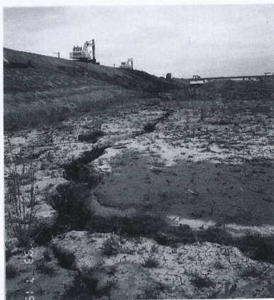
写真 4.3.1 後志利別川河川敷に発生した亀裂 Cracks on river reservation of Shiribeshi-toshibetsu river
