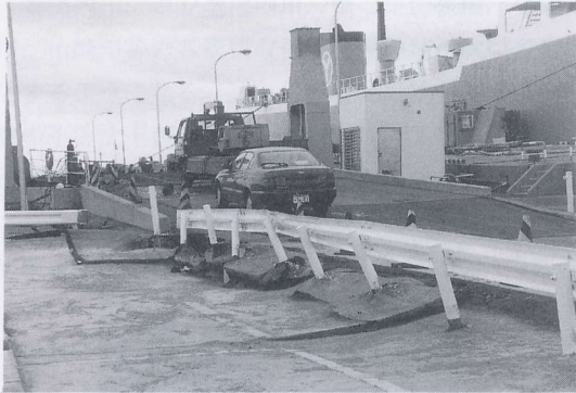
写真 4.9.15 東日本フェリーターミナルの被害 (3) 栈橋アプローチ部分の破壊 Settlement and cracks of pavement near the approach to jetty (H.N.F.T) (3)
