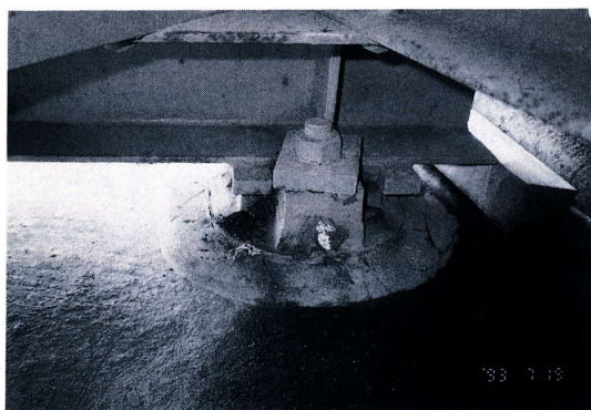
写真 4.4.14 八鈴橋（オチャラッペ川）の右岸橋台支承橋台は相対的に河心側へ移動している Support on the right bank abutment, Yasuzu bridge
