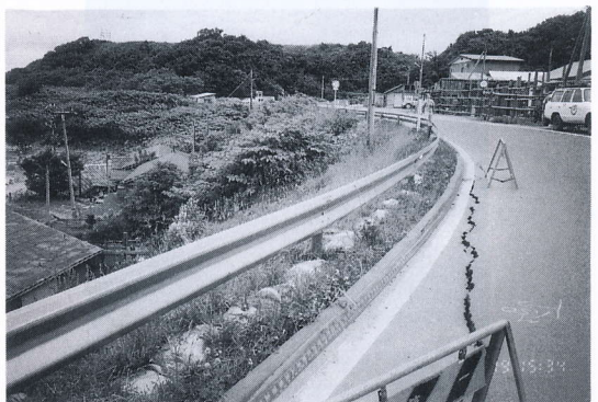
写真 4.4.3 法肩部の亀裂（川尻） 左側斜面下が後志利別川河口部 Longitudinal crack along slope shoulder (Kawaziri)
