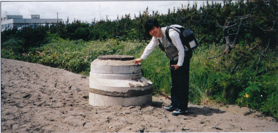
写真 4.10.1 突き出したマンホール（長万部）
