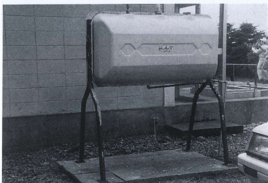
写真 4.4.12 暖房用石油タンクの傾斜 (新成小学校) Tilted oil tank
