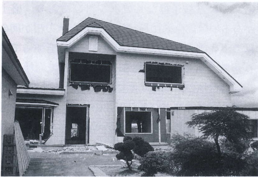
写真 4.4.45 湯浅氏邸の被害（北桧山町徳島真駒内）(1) 新築1年以内の住宅は大きな被害を受けた View of Yuasa's house. Cracks of the ground crossed the house longitudinally (1)
