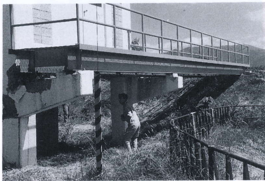
写真 4.7.3 丹羽頭首工の被害 右岸堤防と制御室を結ぶ桁橋、とそれを支持 するRC片持梁部分の被害 Control room of the weir works was damaged (2)
