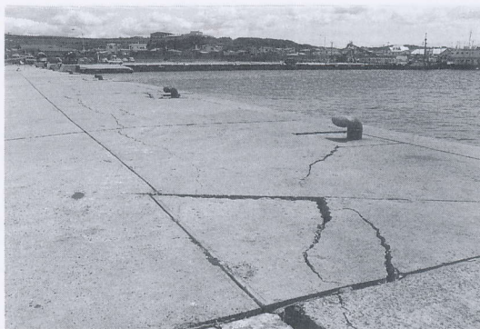
写真 4.2.2 瀬棚漁港の被害 フェリーターミナルのある岸壁。海側へせり出し、コンクリート床版は不等沈下し、法線に沿って2~3条の亀裂が入った Cracks on concrete slab (Setana Fishing Port)
