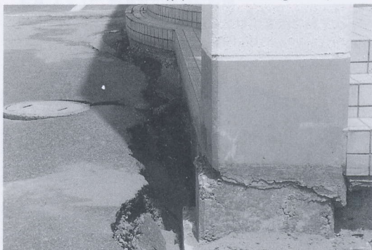
写真 4.2.4 瀬棚漁港の被害 ターミナルビル周辺地盤の沈下と柱基部のずれ (2) Relative displacement between foundation and pillar (Setana Fishing Port)
