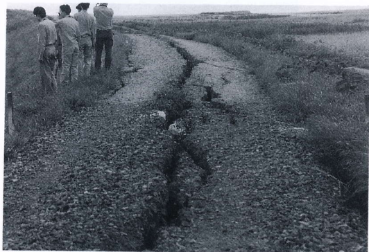
写真 4.3.14 後志利別川河口部左岸堤防の被害 (2) Longitudinal cracks on embankment (Shiribeshitoshibetsu river) (2)
