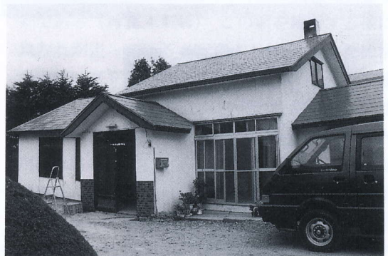
写真 4.4.39 著しい被害を受けた山崎氏邸(今金町八東地区)(1) 現在は宅地に造成されている旧河道の岸の部分にかかって住宅が築造されている Severely damaged Yamazaki's house on the land reclaimed from an old river shore (1)
