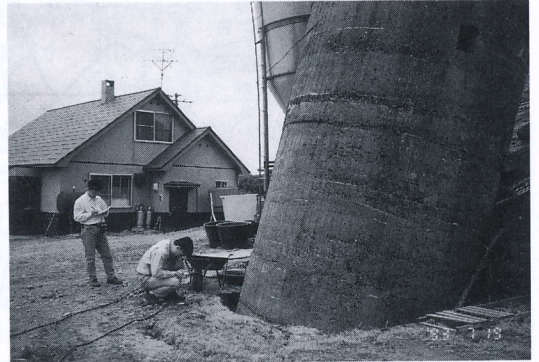
写真 4.3.6 傾いたサイロ Tilted silo
