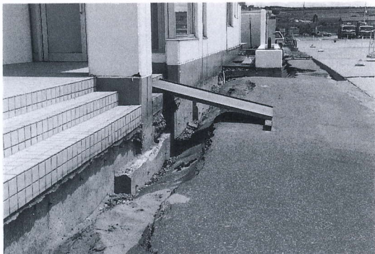
写真 4.2.5 瀬棚漁港の被害 ターミナルビル南東側の地盤の沈下状況と柱基部の水平亀裂 (3) Ground settlement and horizontal cracks at pillar base (Setana Fishing Port)
