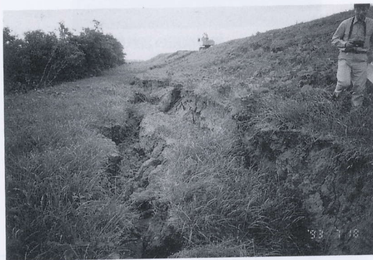
写真 4.3.8 堤内地側法面と押え盛土との境に発生した亀裂 Cracks on the slope of embankment (Shiribeshitoshibetsu river)
