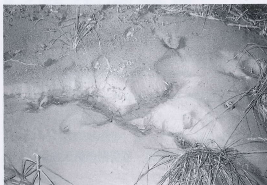
写真 4.10.11 紋別橋左岸橋台付近河川敷に発生した液状化と噴砂 Spouted sand near abutment (Monbetsu bridge)
