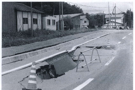
写真 4.4.18 パンケオイチャヌンペ川鈴金橋上流左岸沿いの道路の被害 Damaged road along the left bank of the Panke-oicha-nunpe river
