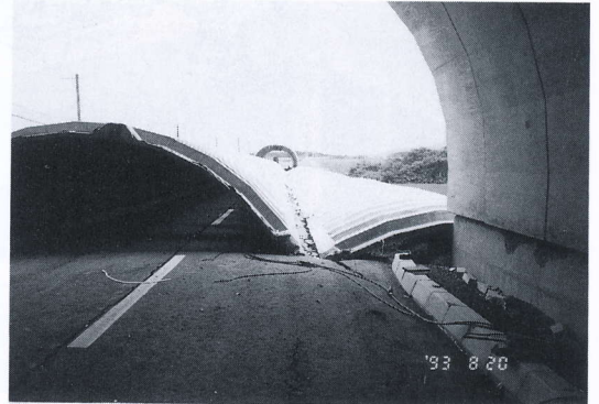
写真 4.1.13 千畳坂覆道の被害 (2) Damage to Senjo-zaka shed (2)
