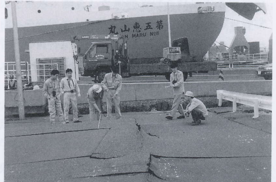
写真 4.9.16 東日本フェリーターミナルの被害 (4) 前面護岸の背後の状況 (1) Uneven settlement of pavement (H.N.F.T) (4)
