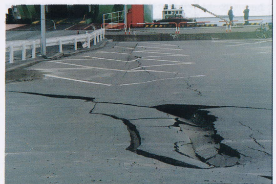
写真 4.9.14 東日本フェリーターミナルの被害(2) 舗装の沈下、亀裂 Settlement and cracks of pavement near the approach to a jetty (H.N.F.T) (2)
