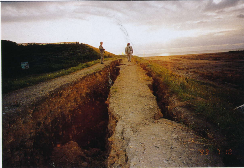
写真 4. 3. 15 後志利別川河口部左岸堤防の被害 (3) Longitudinal cracks on embankment (Shiribeshitoshibetsu river)(3)
