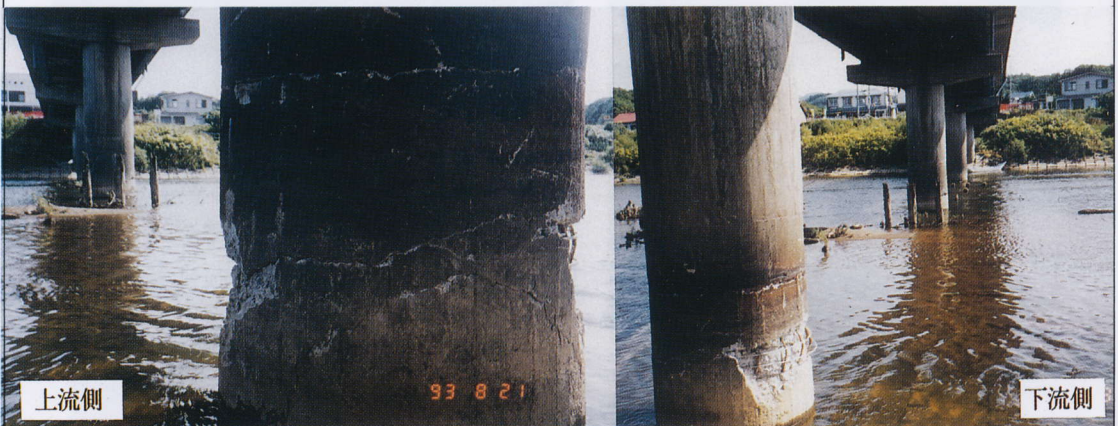
写真 4.8.7 橋脚の被害状況 Cracked pier of the Motoe bridge
