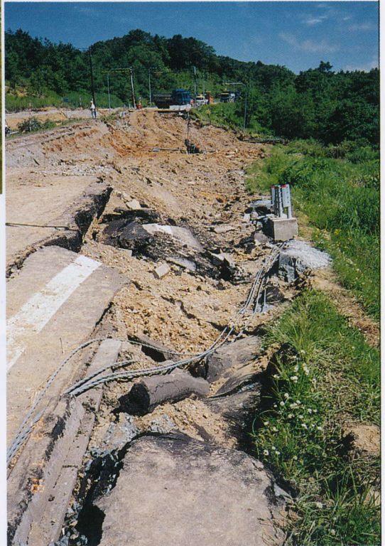
写真 4.10.16 国道5号線双葉-蔵岱間の盛土被害
