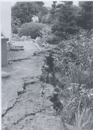
写真 4.4.44 著しい被害を受けた山崎氏邸 (今金町八束地区) (6) 家屋周辺地盤 (旧河川側) に入った亀裂と沈下 Cracks and settlement of the ground around the house (6)
