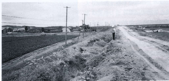
写真 4.3.3 堤防上道路脇の縦亀裂 Longitudinal cracks on embankment
