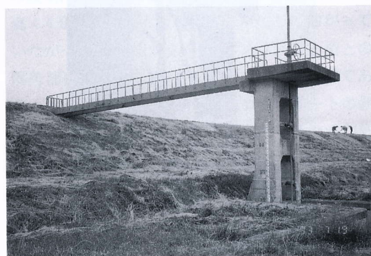
写真 4.4.13 後志利別川左岸オチャラッペ川流入地点付近の樋門 周辺地盤が僅かながら沈下している The ground around culvert settled down by several centimeters
