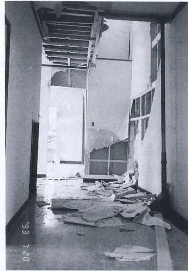
写真 4.4.47 湯浅氏邸の被害（北桧山町徳島真駒内）(3) 家屋内部は沈下、変形して破壊している Damage inside of the house (3)
