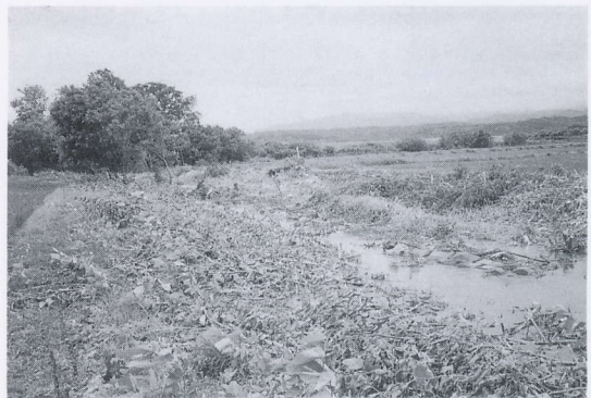
写真 4.4.31 今金町豊田の農道の被害(10) 川幅は狭められ、川底は押し上げられている Bottom concrete blocks of the channel were heaved up (10)
