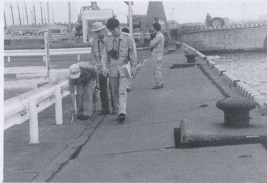
写真 4.9.17 東日本フェリーターミナルの被害 (5) 前面護岸の背後の状況 (2) Settlement of backfill behind quay wall (H.N.F.T) (5)
