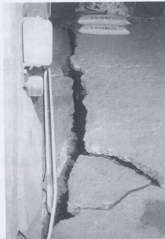
写真 4.4.42 著しい被害を受けた山崎氏邸 (今金町八束地区) (4) 納屋のたたきに生じた亀裂 Crack on the floor of warehouse (4)
