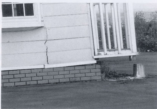
写真 4.10.14 レストラン建物の端部が変形し浮き上がっている Distortion of the restaurant gave a lift to its right corner. (3)
