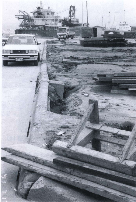
写真 4.9.10 函館港北埠頭の被害 岩壁背後の埋立部の液状化 Liquefaction of reclaimed land behind quay wall, Kita-Futo, Hakodate port
