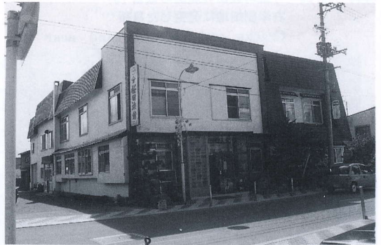
写真 4.4.36 宿舎（桜田旅館）(1) 外部からは被害は殆んどみられないが、内部はかなりの変状があった Sakurada inn. The interior was fairly damaged (1)
