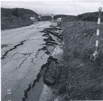
写真 4.3.4 兜野地区の道路被害 Damage to road in Kabutono district
