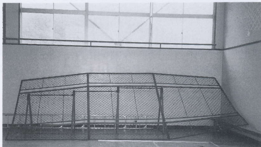
写真 4.4.10 落下したボール除け金網の格子枠（新成小学校体育館） Steel net lattice fell down in the gymnasium
