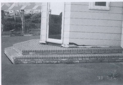
写真 4.10.13 紋別橋直ぐ北のドライブインの被害(2) 入口部は浮き上がっている Entrance of the restaurant was lifted up (2)
