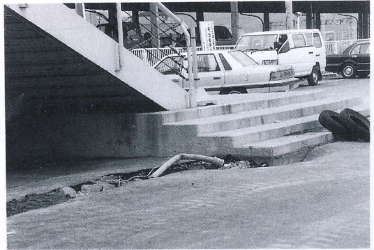
写真 4.9.5 地盤の不等沈下(シーポートプラザ) Uneven settlement due to liquefaction (Sea Port Plaza)
